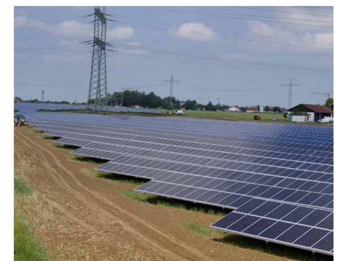
PV-Park Burgkirchen - 1,3 MW / Canadian Solar CS 245 Watt Wechselrichter: SolarMax, Bauzeit: 6 Wochen
